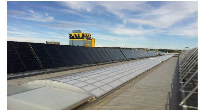
HABAU Energiezentrale (Perg)
